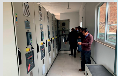
Sala de Controle
